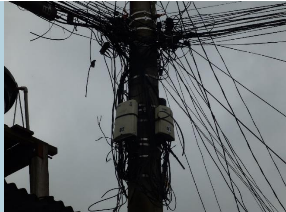
Conexão de energia clandestina na comunidade Santa Cruz dos Navegantes em Guarujá/SP.
