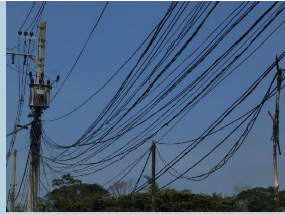
Conexão de energia clandestina na comunidade Baleia Verde em São Sebastião/SP.
