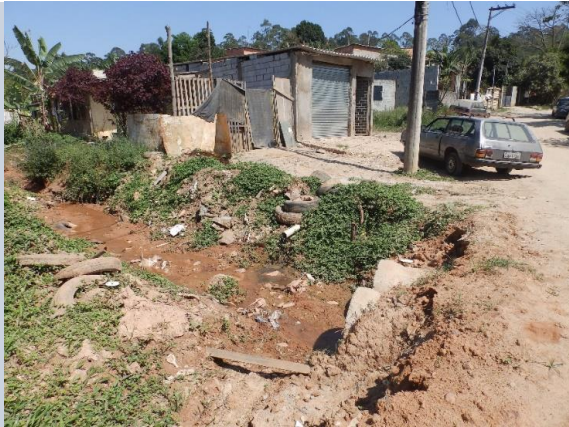
Lançamento de esgotos em córregos - Jardim Canaã/ Itaquaquecetuba/SP.
