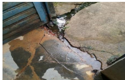
Vazamento em Estação Elevatória de Água Município de Pedreira - 2016
