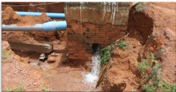
Rompimento de adutora de água em Espigão D'Oeste (RO).
